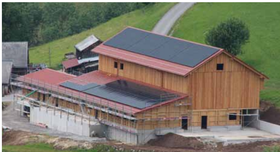
Die Solarmodule auf dem Geren-Stall haben eine Fläche von 375 m 2 und werden pro Jahr ca. 60'000 kWh Strom produzieren.
